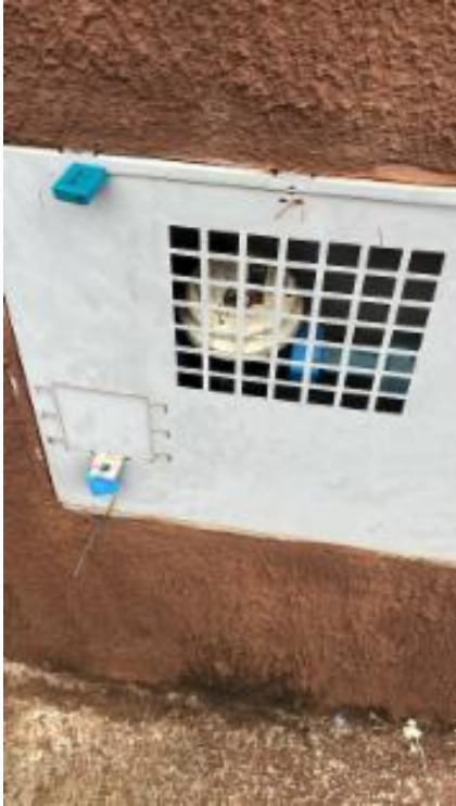
Medidor de água
