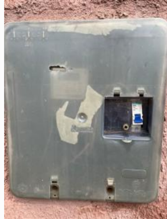
Medidor de energia
