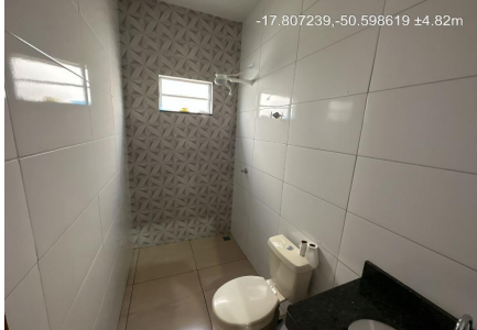
Representação Banheiro Descrição Data Foto 23/06/2023
